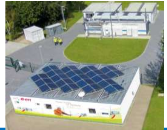
1.5 MW PEM Module
